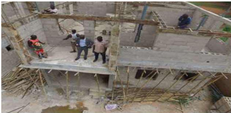
Rajah 3 Imej dari dron yang menunjukkan pekerja tidak memakai sebarang alat perlindungan diri (PPE)
